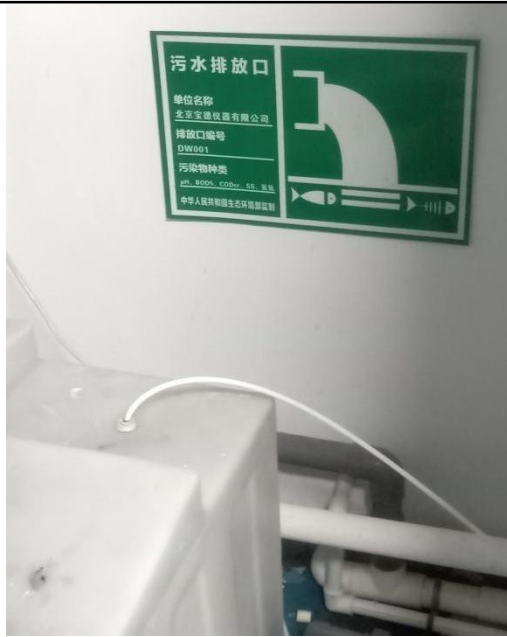
自建污水处理设施标识牌
