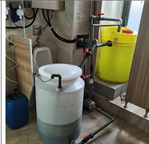
污水处理设施
