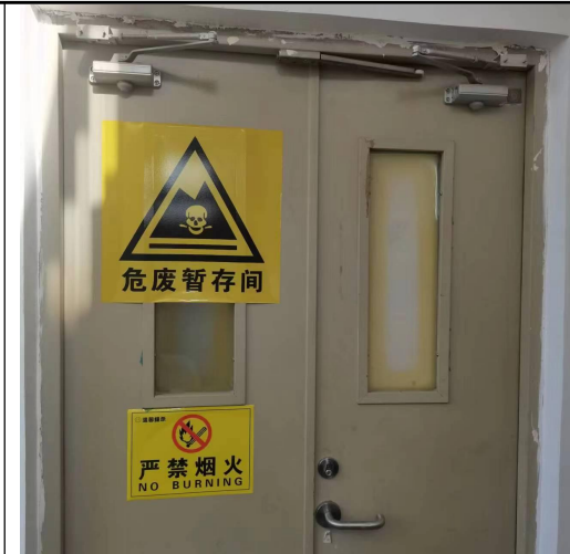
危废间（标识牌待整改）
